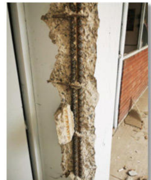
FALLAS EN COLUMNAS (DESPRENDIMIENTO DE ÁREA DE RECUBRIMIENTO)
