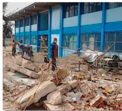
CAÍDA DE BARDAS
