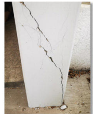
FALLAS EN COLUMNAS POR CORTANTE
